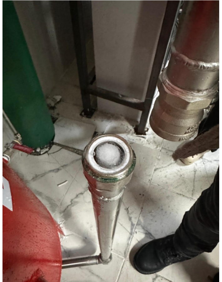
Donma Nedeni ile Çatlayan Paslanmaz Çelik YSS Boruları
