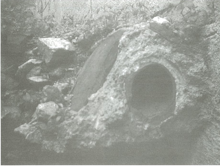
Şekil 8. Ayasofya'nın kuzey bahçesindeki parçalanmış su boruları
